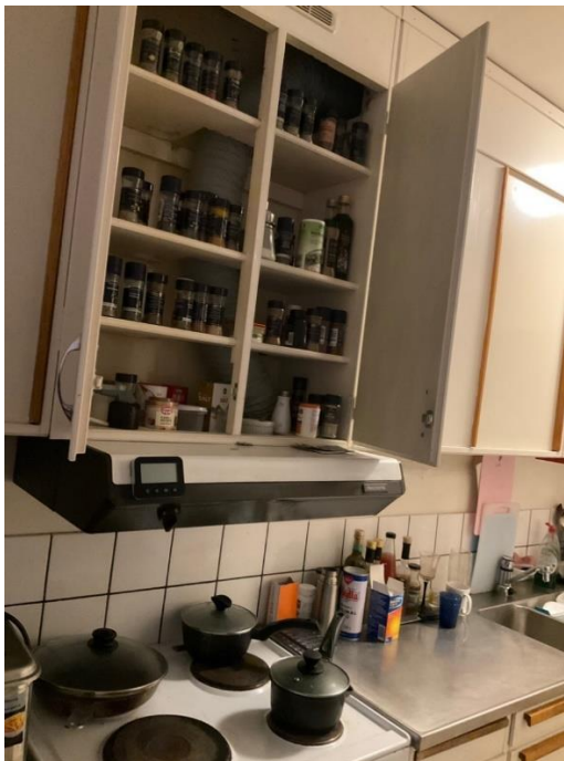
Bild på lösning innan projekt, fläkt kopplad direkt på ventilationskanal utan injusteringsmöjlighet
