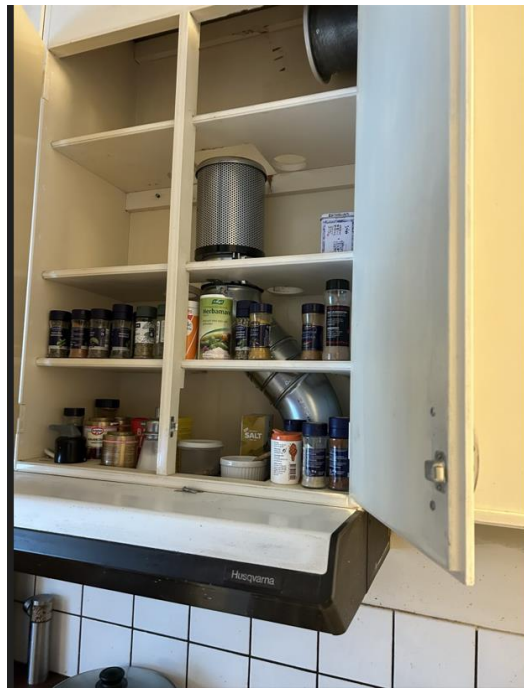
Kolfilter monterat på befintlig köksfläkt samt grundflödesdon i takanslutning
