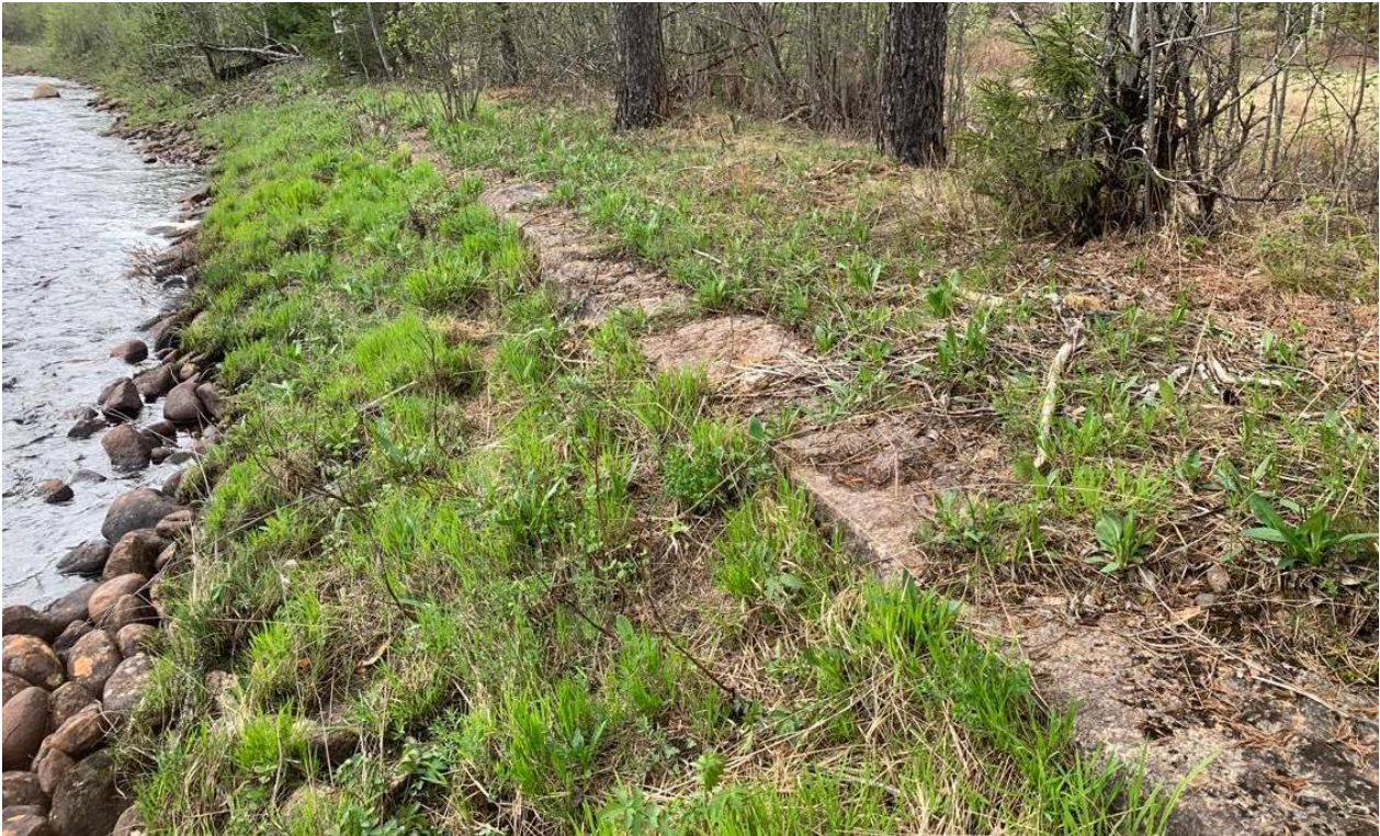
Figur 12. Natursten uppschaktat/pressat mot intakt kilstensmur nedströms plats 4. I bakgrunden, bakom träden syns ett forna svåmplan/älvbotten.
