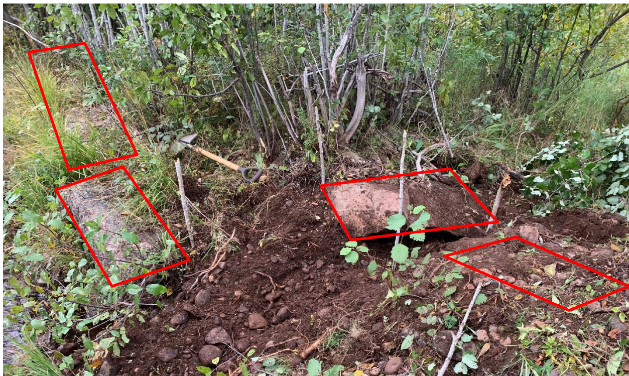
Figur 10. Schaktskadad mur efter åtgärd, kilstenarnas ungefärliga ytterkanter markerade med röda streck.
