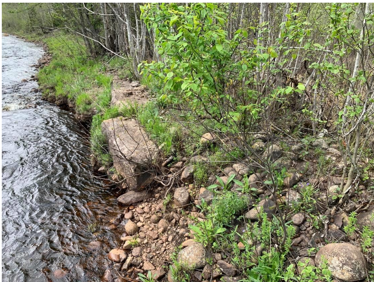
Figur 9. Schaktskadad stenmur före åtgärd. Fotat medströms.
