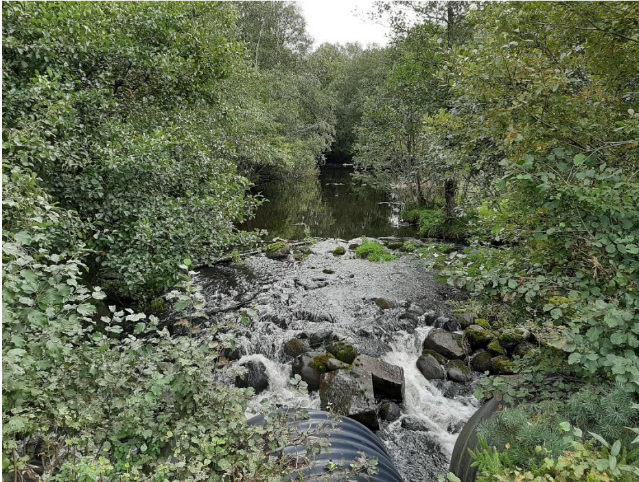
Figur 9. Den nedersta tröskeln före åtgärd 2019.
